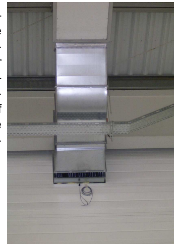
Luftansaugstutzen und Temperaturfühler
